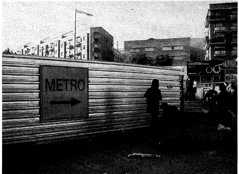
La zona tancada on s'estan fent els treballs de les obres del metro, ahir. / I.M.
